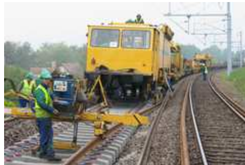
Longs Rails soudés sur traverses béton
