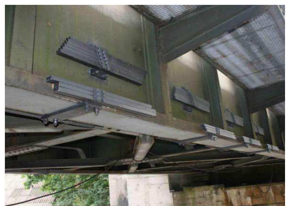
absorbeur sur platelage
